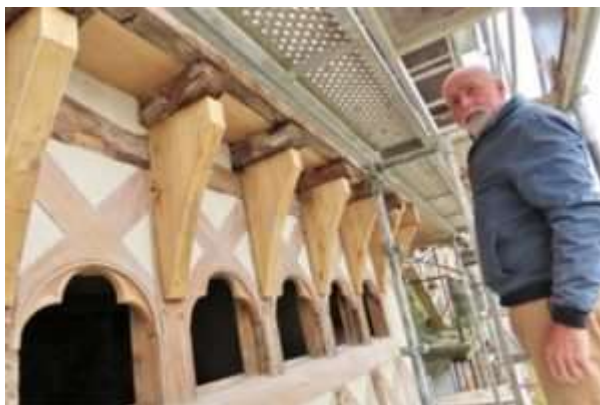
Monsieur Vincent GOUSSET pendant les travaux de restauration de la façade de sa maison construite en 1416, Place du Centre à Guingamp
